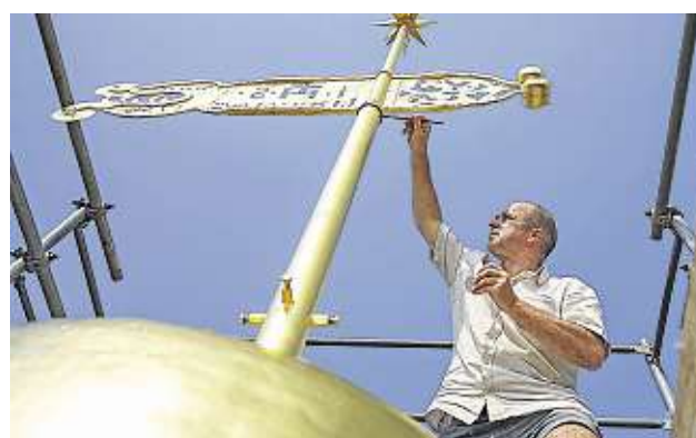
Ganz zum Schluss hat Schriftmaler Konrad Riedel aus Zittau noch kleine Schadstellen ausgebessert.
